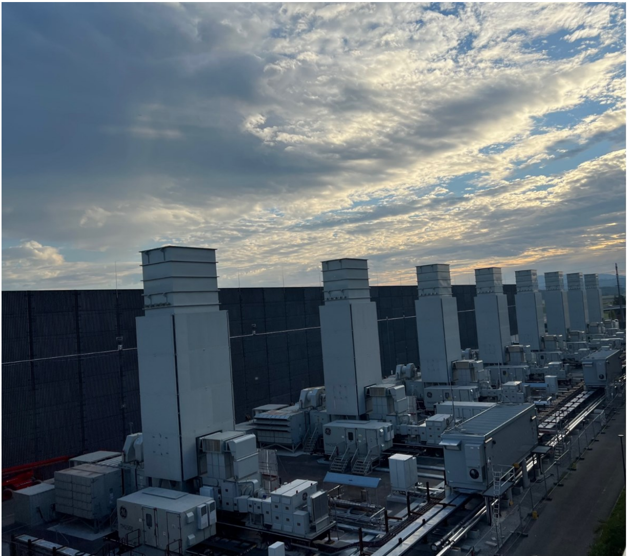
Foto des temporären Reservekraftwerks in Birr (AG) auf dem Betriebsgelände von General Electric (GE)
